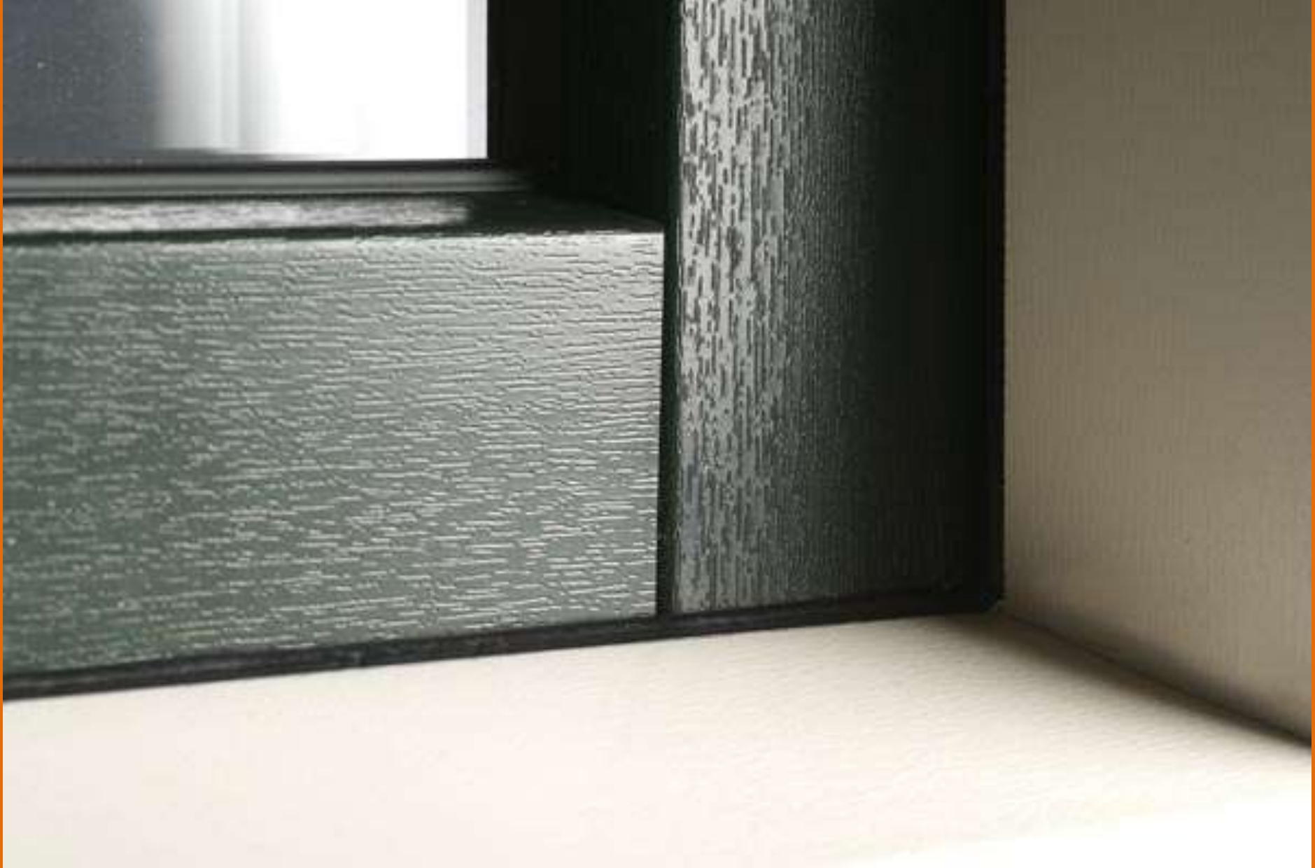
Met houtnerf; imitatie van het verkeerde kozijnhout!
